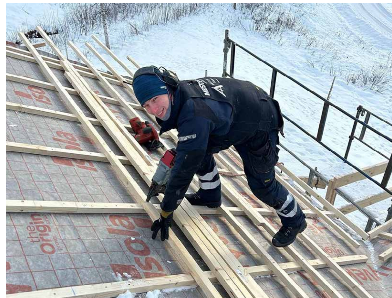
PETTER TEKSLE: – Vi får brukt kroppen og jobber både ute og inne. Samtidig er vi «problemløser» og skaper noe varig og verdifullt for folk.
